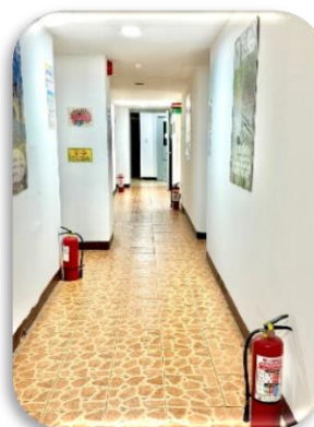
完善的消防設備
